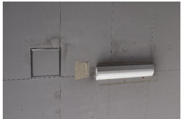
車庫天井の状況
